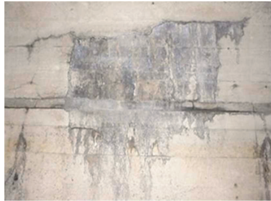
写真-10 表面洗浄後の汚れ除去不可能箇所
